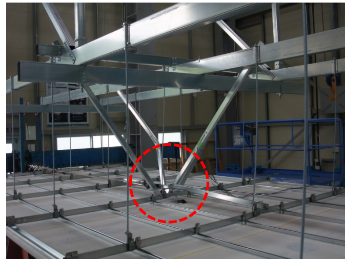
終局状況 (接合部の降伏に伴う部材の座屈)
