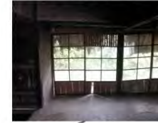
基礎組の腐食により最大10cm沈んでおり建具が動かなかった
