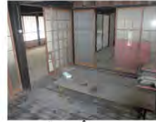
ガラス障子のはめ込まれていた
