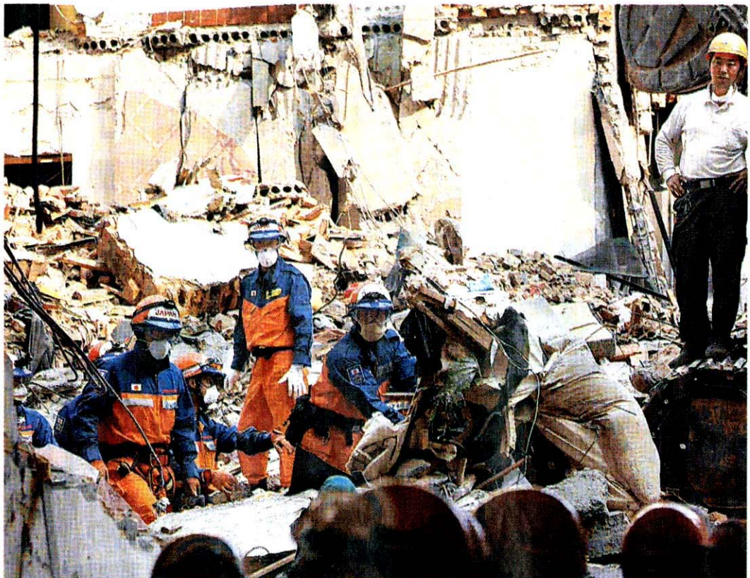
崩壊した病院の職員宿舎で生存者の捜索活動をする日本の国際緊急援助隊。16日午後5時22分、四川省青川県喬荘、樺山晃生撮影
