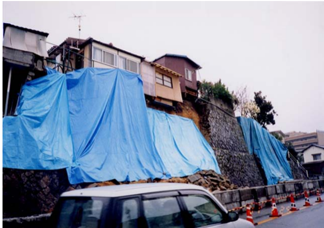
石積み擁壁の倒壊(呉市)
