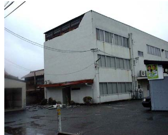
建物外壁の剥落(熊野町)
