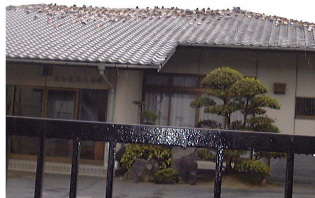
瓦屋根の被害(熊野町)
